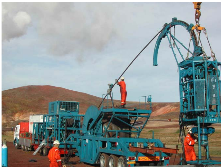
Brønnservice, hydrauliske rør
